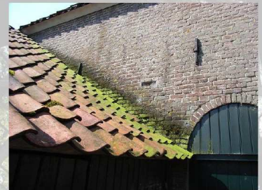
Een verholen goot onder de laatste pan tegen de gevel
