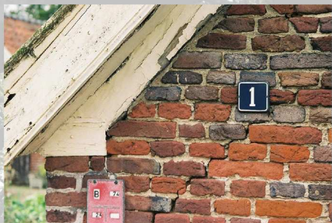
Scheuren in metselwerk veel voorkomend, wat te doen?
