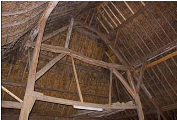
Afbeelding 50 Een wankel gebintconstructies met te weinig hout, waardoor er te veel beweging in de kap zit.
