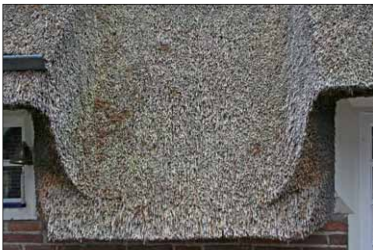
Afbeelding 51 Links van de dakkapel is een groene was te zien van algvorming.
